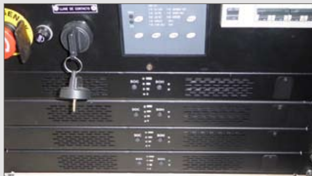
Sistema de 4 baterías rack 19" 1U-Potencia
